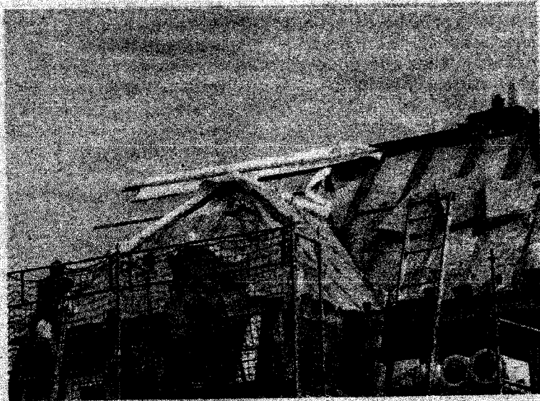
La rénovation énergétique est un secteur fortement générateur de plaintes pouvant générer des consentieux importants, entre les travaux mal faits et le surendettement. En 2022, le site officiel Signal Conso en a enregistré plus de 10000. © DR
